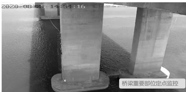
图 15 CCTV 视频监控
