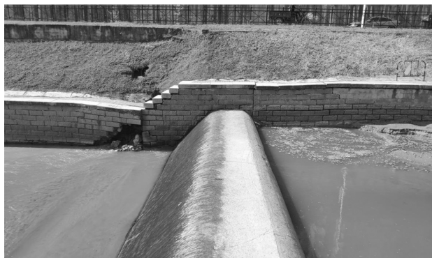
图1 管涌导致挡墙塌陷
