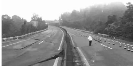
图1 路基不均匀沉降
