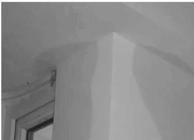
图1 屋面防水渗漏
