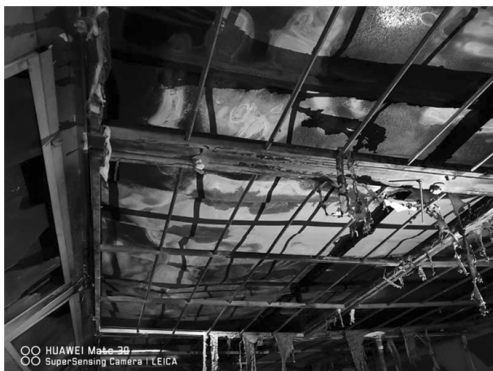
图4 烤漆房内部顶部燃烧变色严重
