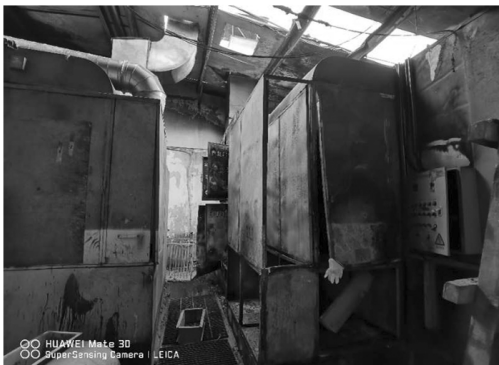
图5 烤漆房环保设备燃烧情况
