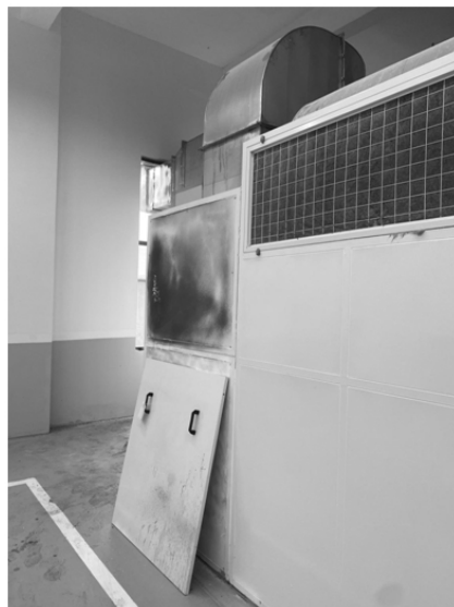
图7 烤漆房环保设备燃烧情况
