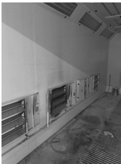
图6 烤漆房电热丝燃烧情况
