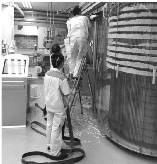
图4 连接装置引发故障的维修
