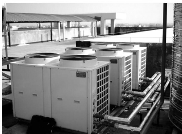
图 2 绿色建筑给排水中的水泵装置
