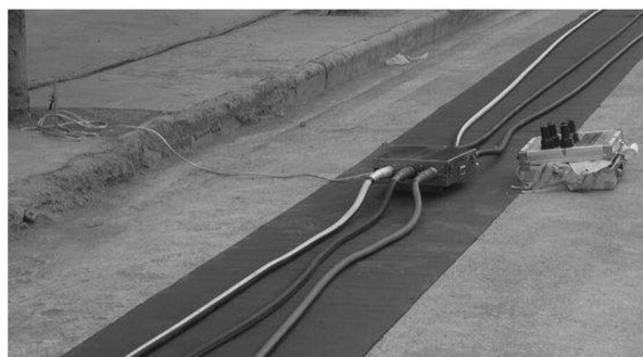
图2 旁路柔性电缆
