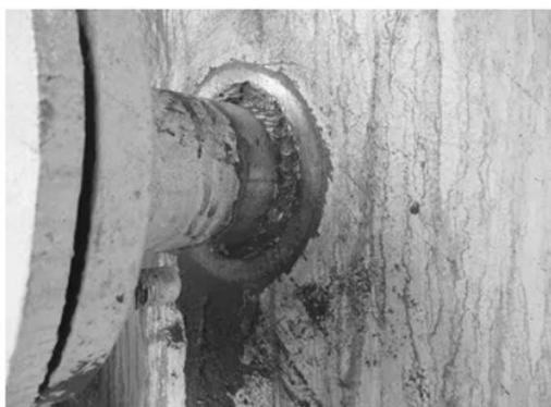
图 2 化工机械腐蚀泄漏
