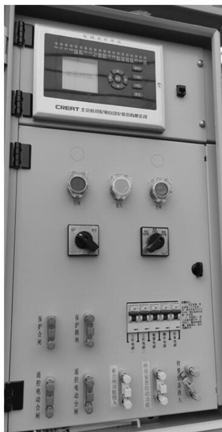
图3 配电监控设备
