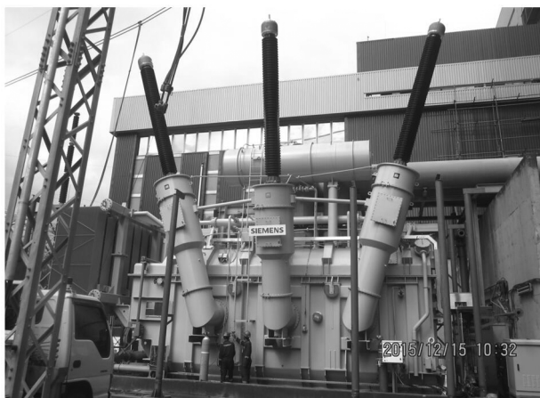
图4 工作人员在对电力变压器在进行日常下检修和维护
